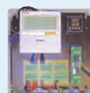
Плата управления, силовой трансформатор, клеммы подключения
